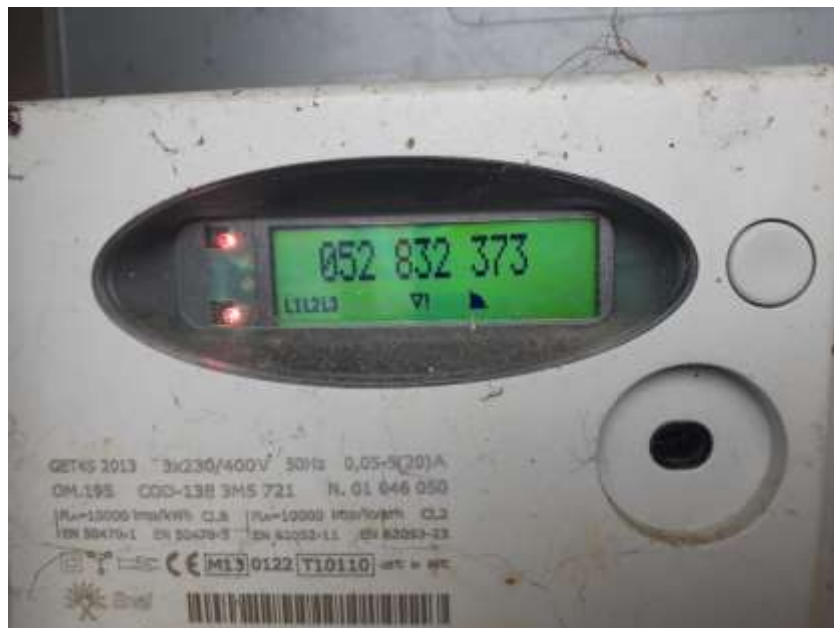
CONTATORE PRESENTE NEL VANO TECNICO
