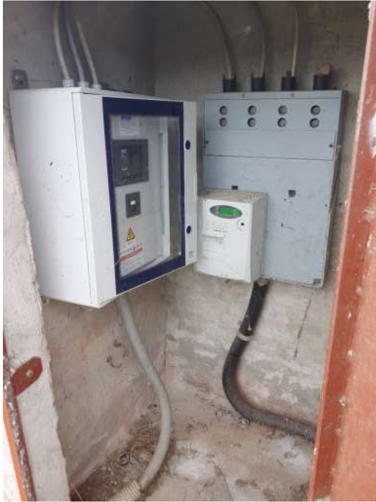
DETTAGLIO INTERNO DEL LOCALE TECNICO DI ALLOGGIAMENTO DEL CONTATORE
